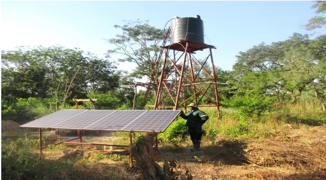
De watertoren met pompinstallatie op zonne-energie.
