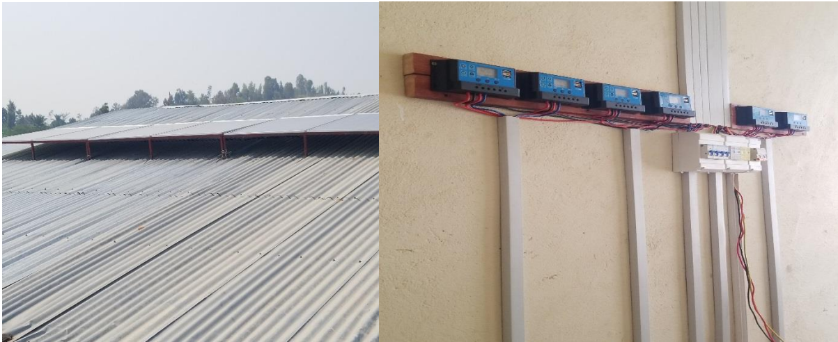
Fig.6 Energievoorziening met zonnepanelen.
